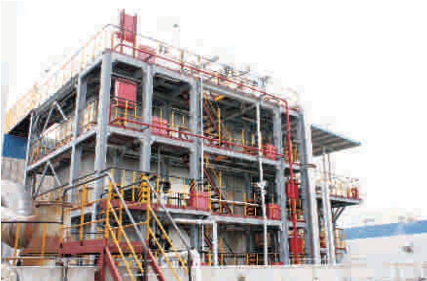
焚烧炉配套的废热蒸汽锅炉
