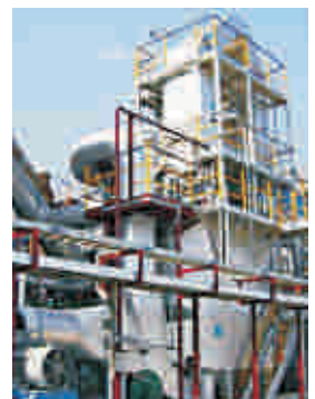
尾气脱硝处理装置以及省煤器
